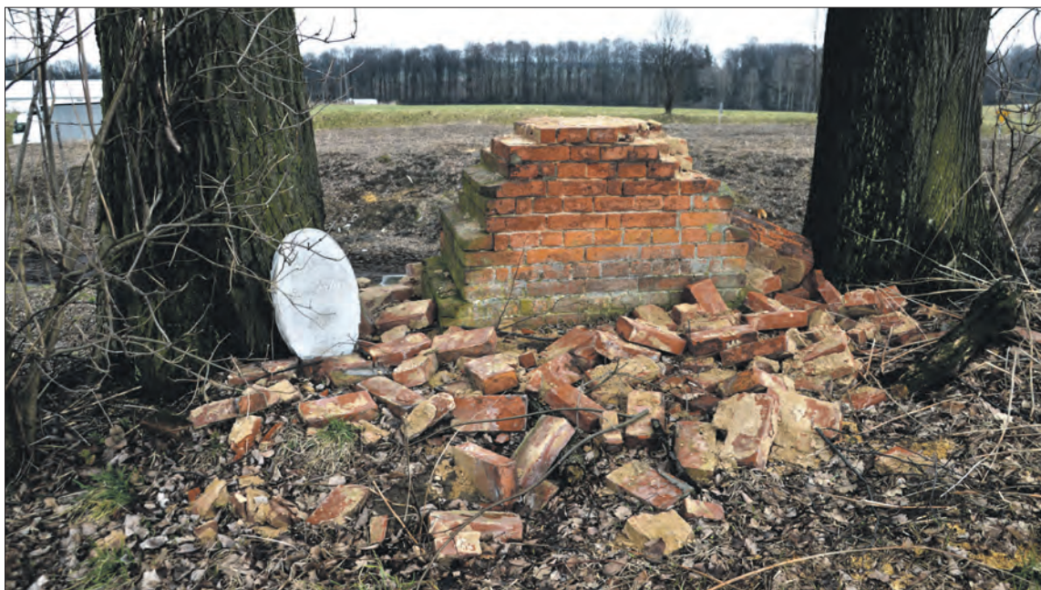
Ze zniszczonego cokołu niewiele pozostało
